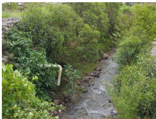
Figura 6. Conexión ilegal de vertimiento
