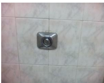
Foto 9: “Sistema hidráulico de los sanitarios”
