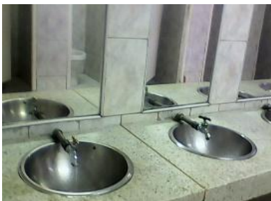
Foto 3: “Desperdicio de agua en los baños de la institución”.
