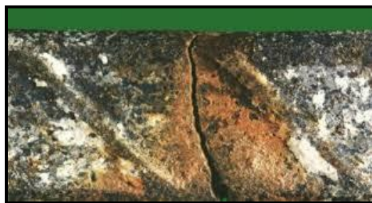
Ilustración 3 Corrosión por Fisuras [12]
