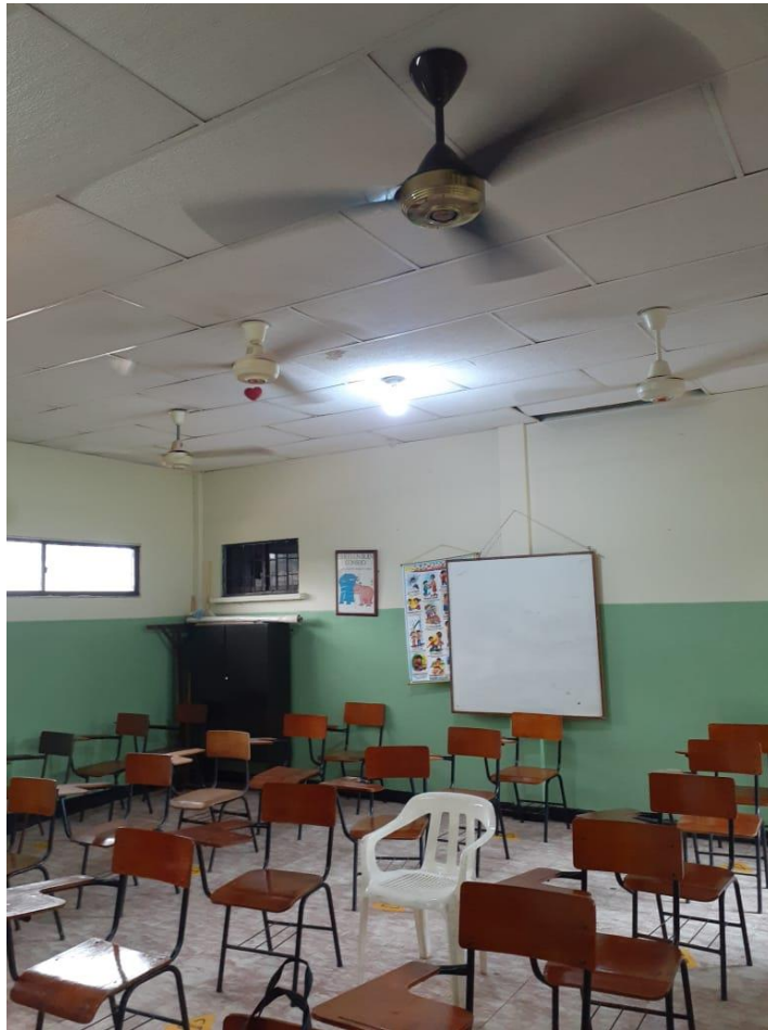
Imagen 1. luces y ventiladores encendidos en un aula vacía.
