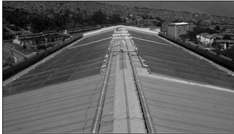
Figura 1. Colectores solares instalados en el hospital Pablo Tobón Uribe (240 m 2 de colectores, tanque 20 m 3 , no visible).
