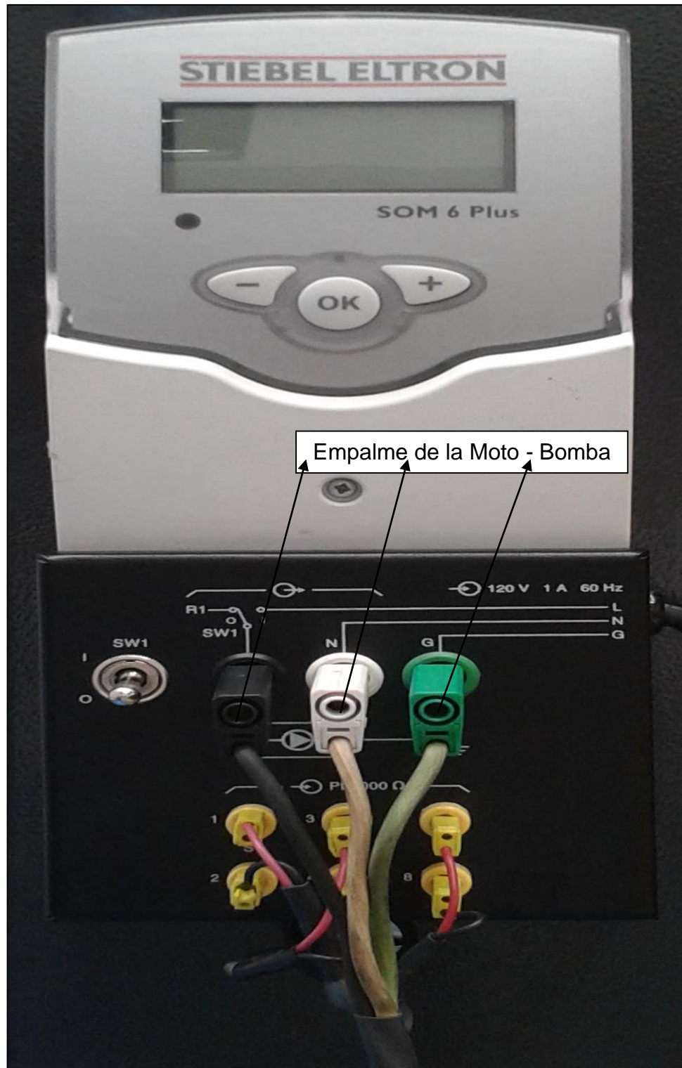
Figura 6. Conexión eléctrica de la Moto – Bomba
